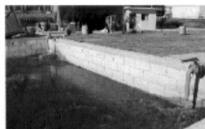
5. Descarga de lodos
